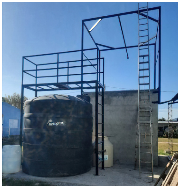
Figura 28. Construcción del reactor de mezcla completa para obtención de biogás a partir de cachaza y vinaza. Comunidad Pueblo de Dios, Colombres, Tucumán. EEAOC.
