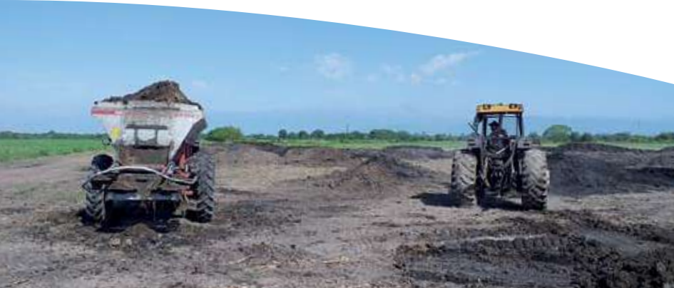
Figura 3. Patio de compostaje.
