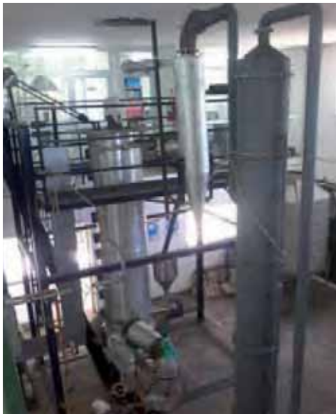
Figura 41. Reactor de gasificación de biomasa con sistema de limpieza y filtrado de los gases combustibles.
