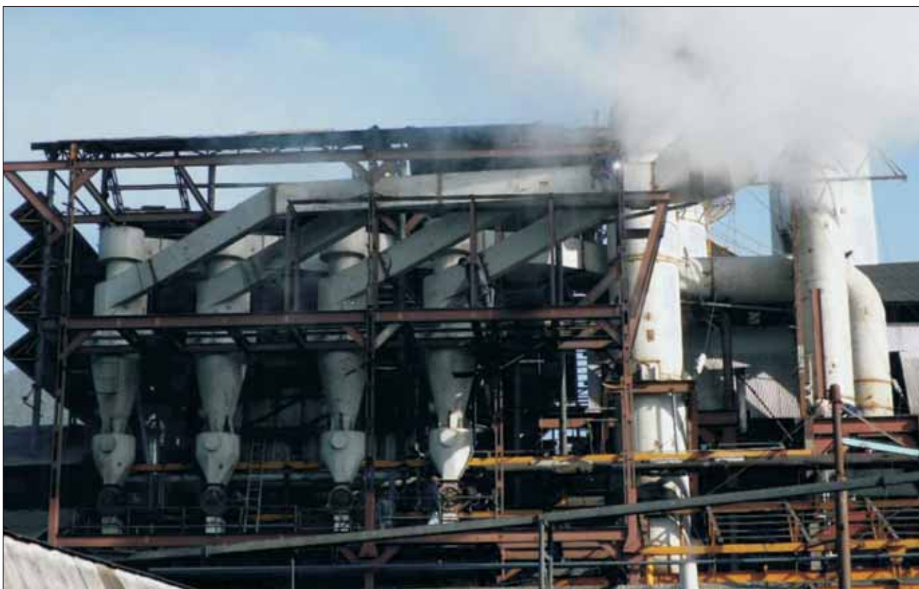
Figura 2. Vista frontal del secador en operación. Ingenio El Carmen, México, 2010.
